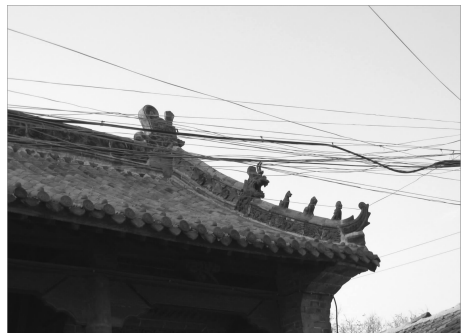
图6 隐患——古城某保护建筑屋顶上蛛网般交错的各种电线
