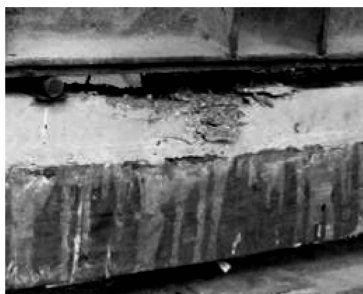
图 13 试验梁破坏(砼压碎)
