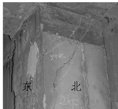
图 2 2×F 柱顶裂缝
