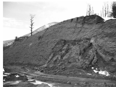
图 7 边坡上的局部垮塌
