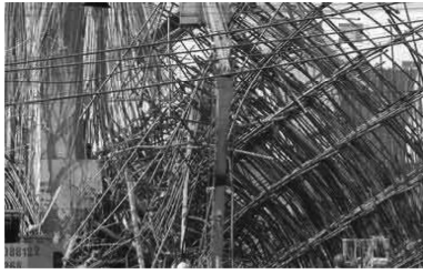
图 1 扣件式钢管模板支架垮塌事故
