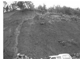
图2 降雨入渗后的失稳边坡
