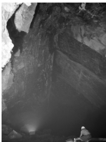
图6 左岸导流洞顶拱塌方照片
