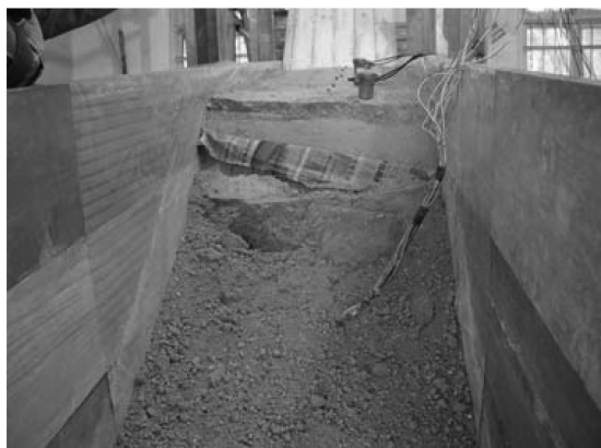
图 7 开挖楔形层面发生崩滑
