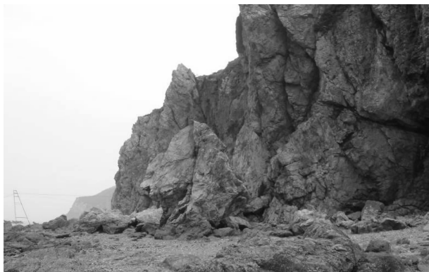
图 6 块状崩落型侵蚀实例
