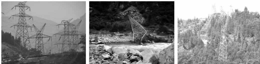
图 1 汶川地震中输电塔和输电线破坏图
