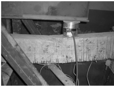
图 6 试验梁加载裂缝开展图
