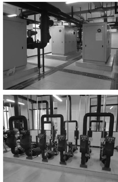
图 2 地源热泵系统机房设备
