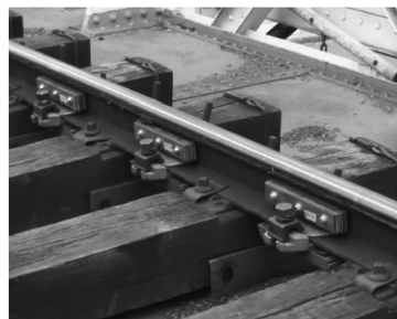
(a)钢轨上安装调频质量阻尼器
