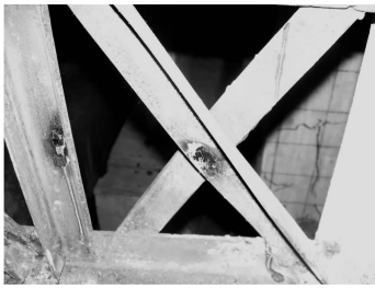
图 11 SW 钢桁架连梁破坏阶段变形
