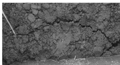
图 8 局部横向裂缝
