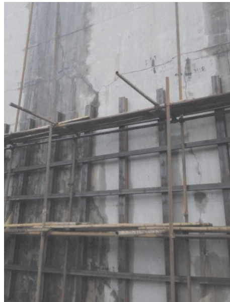
图 2 几处典型的桥墩裂缝图
