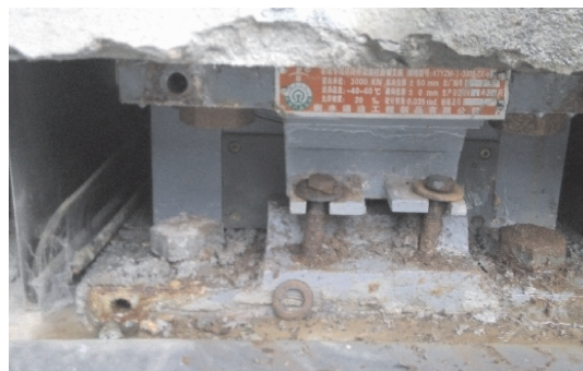
图 3 临时连接支座未及时拆除
