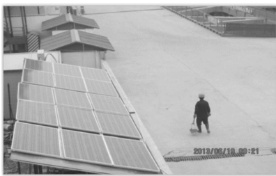
图 1 光电板在临时施工用房的利用
