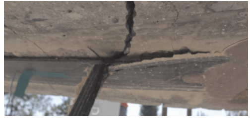
图 12 HB-PRECFRP 加固梁 BM6-1 的破坏形式 Fig. 12 Failure mode of test beam BM6-1
