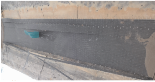
图 10 HB-CFRP 加固 BM2-1 的破坏形式 Fig. 10 Failure mode of test beam BM2-1
