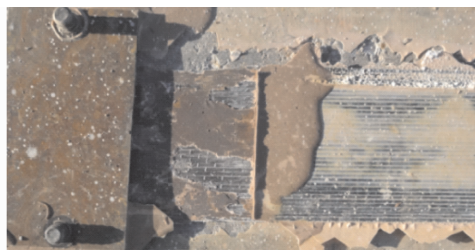
(a) CFRP 滑移及剥离
