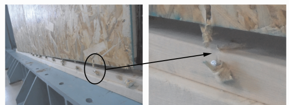
(a) 底梁板部位覆面板边缘被连接钉撕裂
