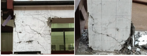
图3 FW-1柱顶、柱底破坏情况
