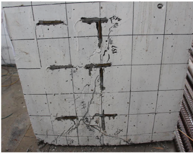
(a) 混凝土块外表面底部竖向劈裂缝分布
