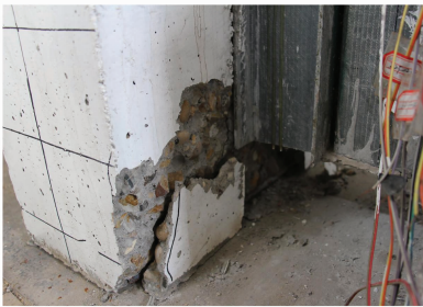
(c) 混凝土块内表面底部八字形劈裂主裂缝分布
