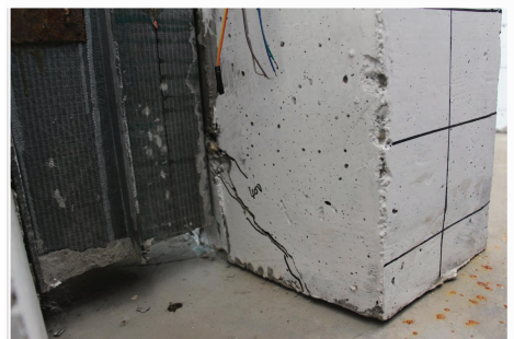
(b) 混凝土块内表面底部人字形劈裂缝分布
