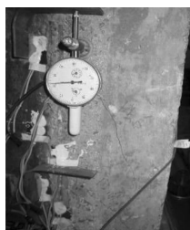
图 8 榫孔处出现斜裂缝
