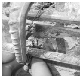
图 9 混凝土榫被压碎
