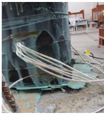
图 6 柱根部裂缝 Fig. 6 Crack of column root
