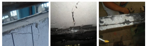
(a) 混凝土被压碎 (b) 梁底横向裂缝 (c) CFRP 板劈裂
