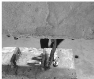
图 6 连接螺栓的断裂
