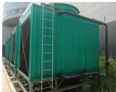
图 5 热源塔现场图
