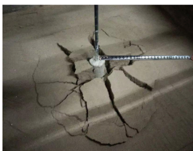
图8 土体表面破坏图
