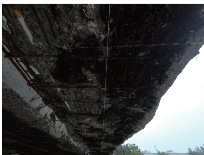
图 7 试验梁底板外观
