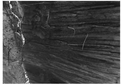
图 5 典型底板混凝土爆裂照片
