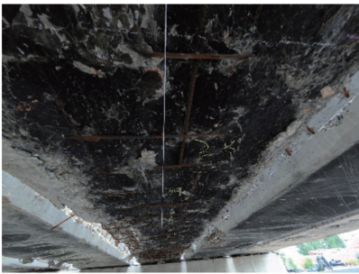
图 4 典型底板剥落照片
