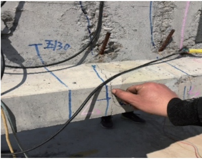
图 13 跨中附近裂缝照片
