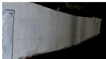
(c) SL-6-U1 中部裂缝剥离破坏
