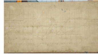
(d) DHB2 裂缝照片
