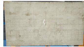
(c) DHB1 裂缝照片
