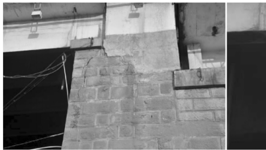
图 1 泸州长江大桥北岸 2 号墩重大安全险情
