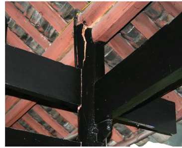
图 7 青城山祖师殿卯口开裂 [30] (汶川地震 11 度)
