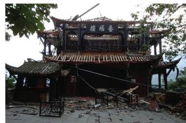
图 4 都江堰秦堰楼 [3] (汶川地震 11 度)
