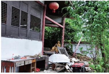
图 9 芦山佛图禅寺柱架倾斜(芦山地震 9 度)
