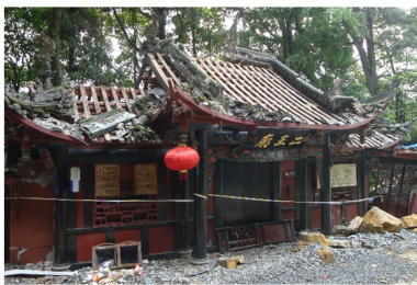
图 10 都江堰二王庙入口屋面溜瓦(汶川地震 11 度)
