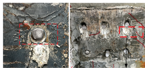
(b) 钢梁侧破坏情况 (c) 混凝土侧破坏情况
