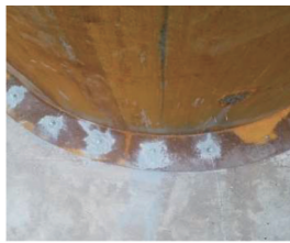
(a) 罐底法兰和膨胀螺栓
