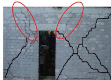
图4 文献[9]中砌体墙W-2开裂情况
