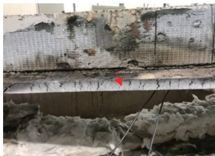
(a) 镁晶板跨中裂缝
