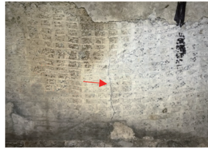
(a) 混凝土板跨中裂缝
