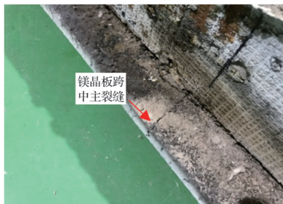
(b) 镁晶板跨中断裂
