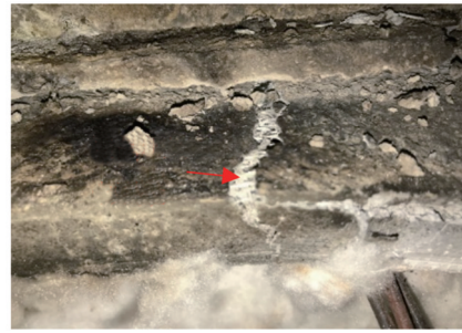
(b) 镁晶板跨中裂缝
