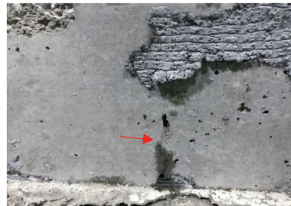
(a) 混凝土跨中裂缝
