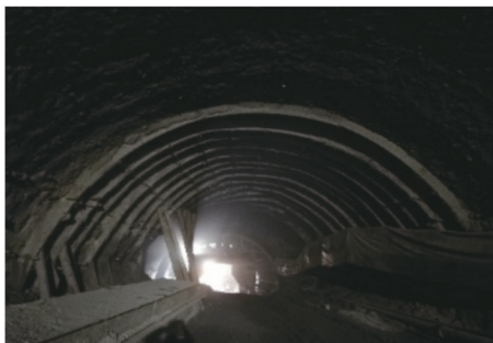
(b) 初支严重侵限
