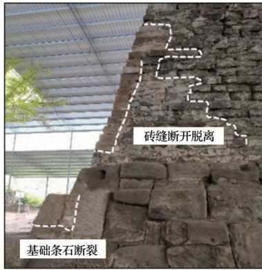
(a) 城墙断裂
