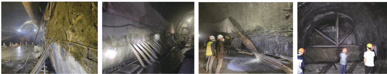
图 16 现场不同隧道鼓包情况
