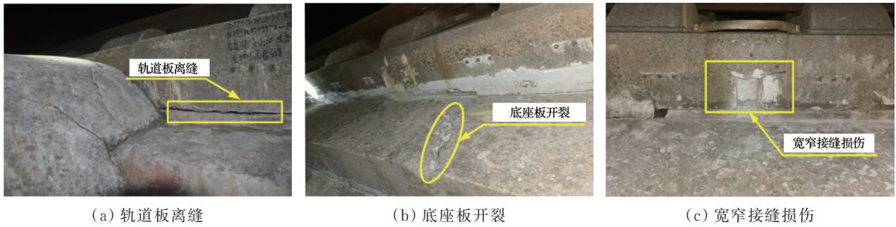
图1 无砟轨道典型损伤模式 Fig. 1 Typical damage mode of ballastless track
