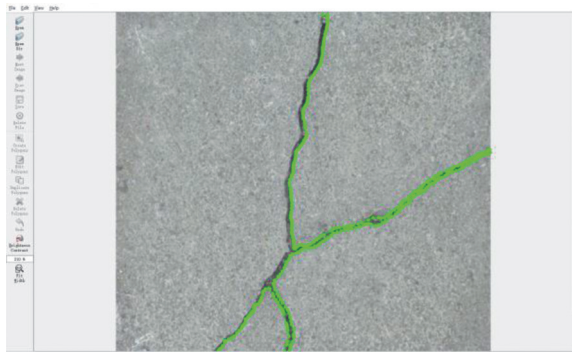
图 2 混凝土裂缝标注过程 Fig. 2 Labeling process of concrete cracks
