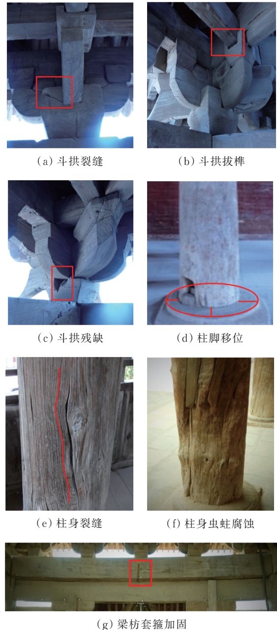
图 2 飞云楼局部残损状态及加固措施
