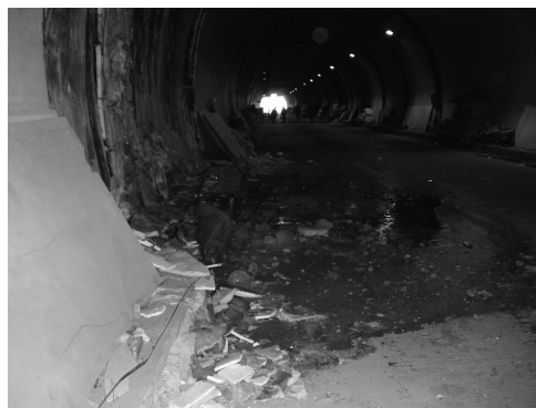
图 5 隧道路面结冰
