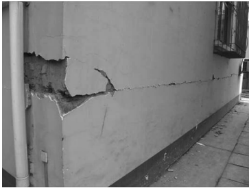
图1 绵竹市天河馨苑砌体结构房屋的底部水平裂缝
