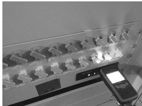
图 5 加装防误操作系统的电力压板
