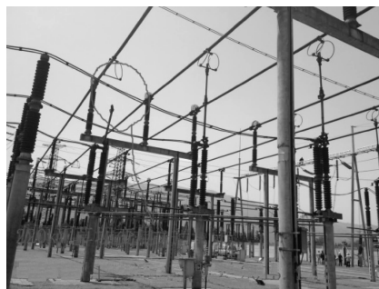
图3 220 kV 草坝变电站母联 2121 隔离开关 C 相断裂
