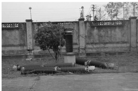
图2 110 kV 金花变电站断路器断裂
