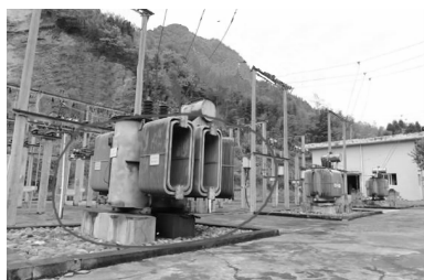
图1 响水滩变电站主变基础垮塌、主变倾斜
