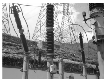
图4 220 kV 溪黄线 265 避雷器断裂
