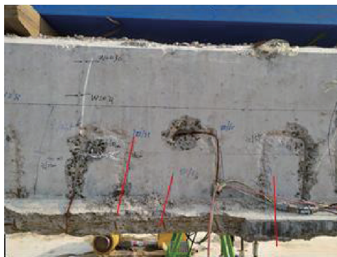
图 13 跨中附近裂缝照片
