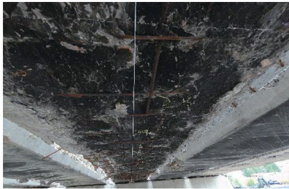
图 2 典型底板剥落照片
