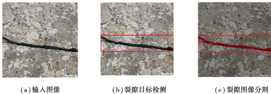
图 2 露天矿边坡裂隙
