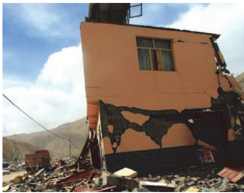
图1 砌体结构震害
