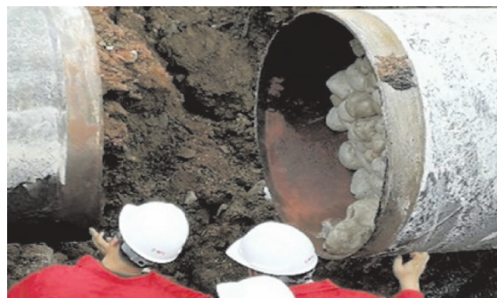
图 2 PGD 作用下管道发生拉伸断裂失效(中缅管道,2017 [11] )
